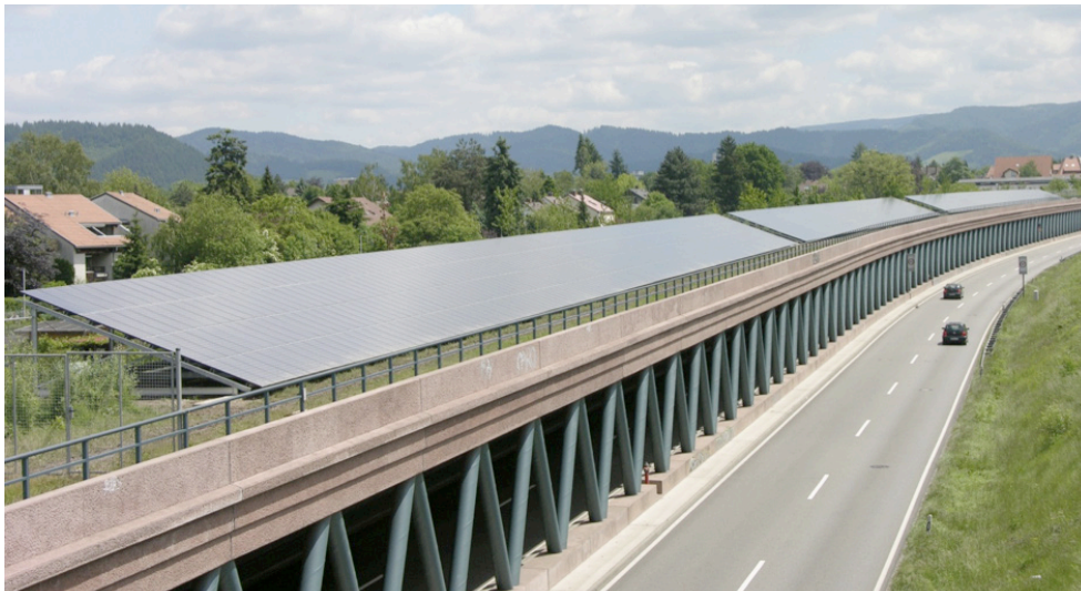
Komunitně vlastněné fotovoltaické panely na protihlukové bariéře ve Freiburgu, Německo. Zdroj: fesa GmbH 2006
