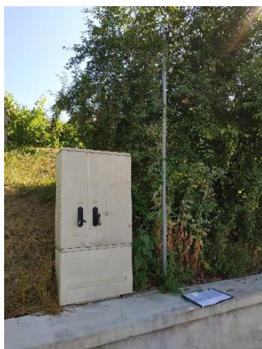
RVO 42 – Pod Valy (celkový pohled a detail rozvaděče)
