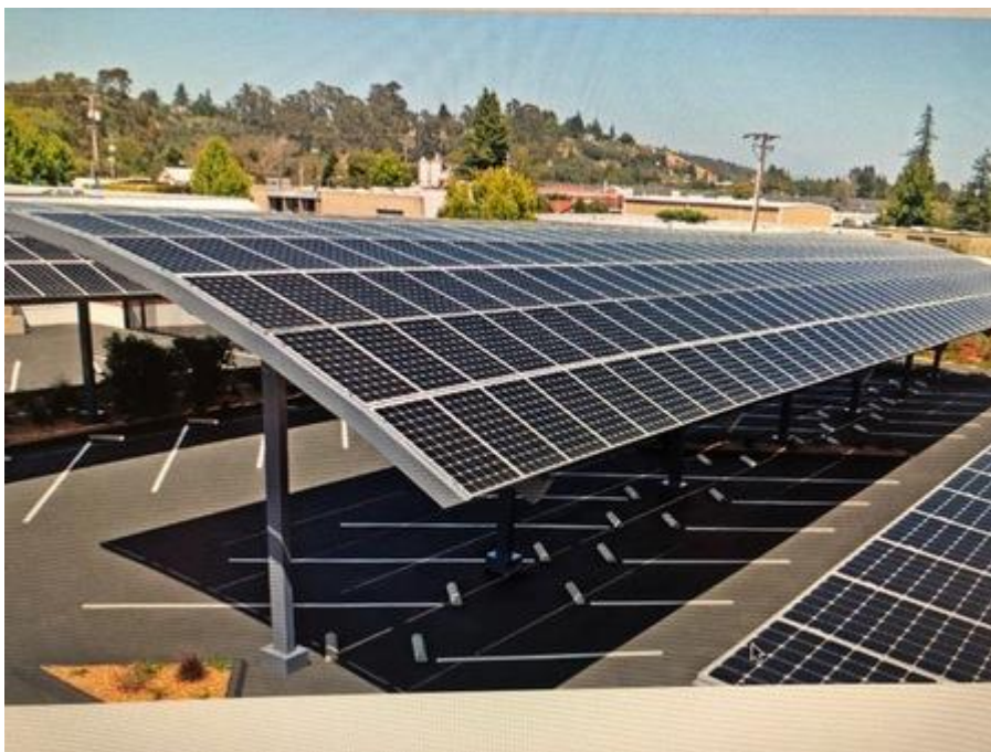
Zastíněné parkovací plochy ( https://www.unitedpower.cz/parkovaci-plochy-solar/ )
