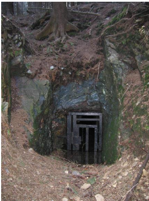
Obrázek č. 64: Zajištěné ústí štoly v revíru Sn rud u Nového Města p. Smrkem (stav IV/2009)
