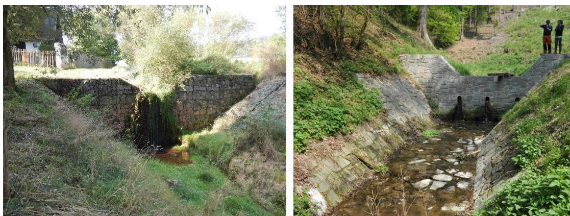
Obr. 26: Přehrážka u obce Domoušice v Ústeckém kraji, vpravo příklad lesní přehrážky na Křivoklátsku
