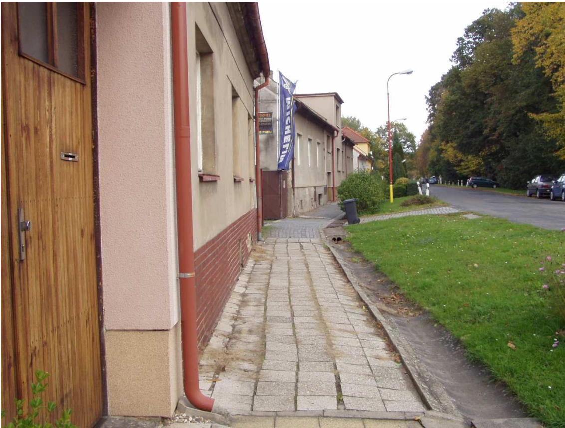
Obrázek 93: Nevhodný stav pěší komunikace, ul. Na Hrázi
