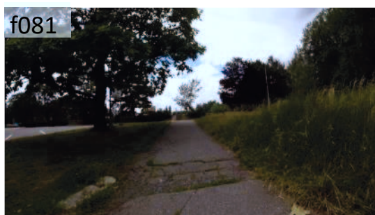
Bariérový úsek chodníku v ulici Václava Soumara /nerovnosti a podélný sklon/.
