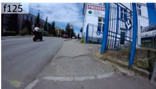
Bariérový úsek chodníku v Soběslavské ulici /nerovný povrch, pochozí plocha není oddělená od vozovky zvýšenou obrubou ani varovným pásem/.
