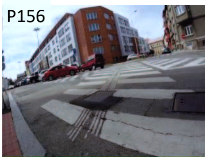
Bariérový přechod pro chodce ve Vančurově ulici /nadměrná délka přecházení bez světelné signalizace či ochranného ostrůvku, přerušený vodící pás, malé nerovnosti/.
