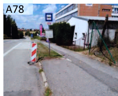
Bariérová zastávka „DITA“ v ulici Stránského /nízký zastávkový obrubník, chybí signální a varovný pás pro osoby s omezenou schopností orientace/.
