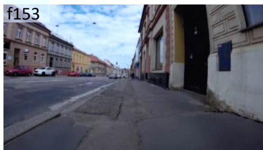
Bariérový úsek chodníku v Budějovické ulici /nerovnosti, zadržování srážkové vody v prohlubních pochozí plochy/.
