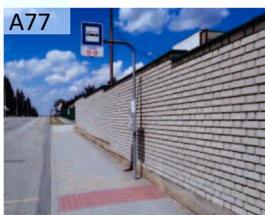
Částečně bezbariérová zastávka „Stránského“ /zastávkový obrubník dosahuje výšky jen 14 cm, chybí varovný pás pro osoby slabozraké/.
