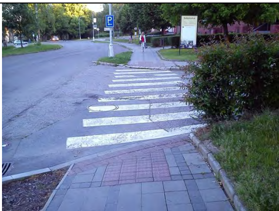
Z3p Přechod u Sokolovny směr Tovární Bariérový Neúplný signální pás. Nenormová délka přechodu. Nedostatečně snížená obruba.
