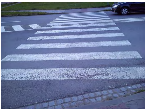
P3p Přechod přes 26. dubna směr Pod Valy Bariérový Nenormová délka přechodu. Krátké varovné pásy. Chybí vodící pás.
