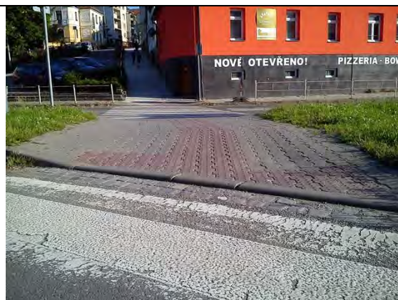
P4p Přechod přes Pod Valy směr U Elektrárny Bariérový Krátké varovné pásy. Nedostatečně snížená obruba.
