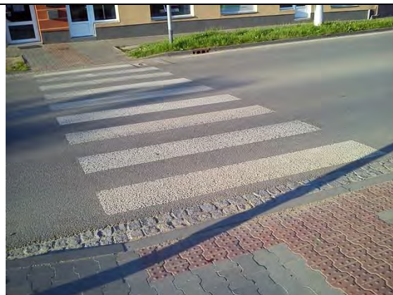
J4p Přechod přes Vlčnovskou u okružní křižovatky Bezbariérový s výhradou Nenormová délka přechodu.
