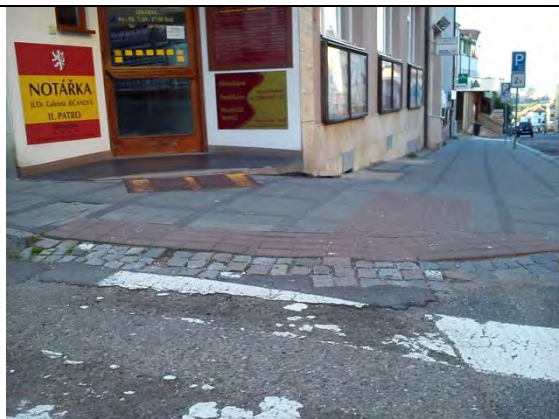
O4p Přechod přes Bří. Lužů směr Masarykovo náměstí Bariérový Neúplný signální pás. Nerovnosti vozovky.
