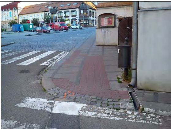
O5p Přechod přes Soukenickou směr Masarykovo náměstí Bariérový Neúplný signální pás. Nerovnosti vozovky. Nestandardní vyvedení okapového svodu.
