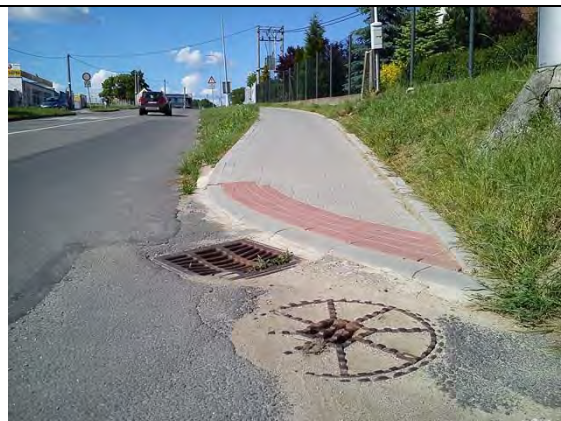
S2 Místo pro přecházení přes napojení Horního Dvora Bariérový Chybí signální pás. Nerovnosti vozovky.
