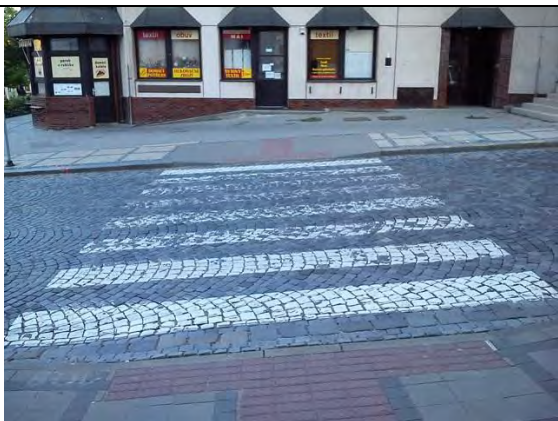
O1p Přechod před radnicí Bariérový Na obou stranách jsou neúplné signální pásy. Varovné pásy jsou nedostatečné délky.
