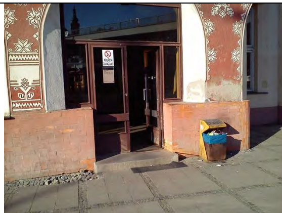
P2 Vstup do objektu vlakové stanice Bariérový Chybí nájezdová rampa.
