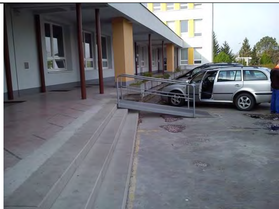
S5b Vchod do nemocnice Bezbariérový s výhradou Přístupová rampa vede do parkujících vozidel.
