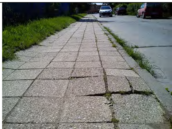
S3 Chodník Na Tržišti směr ZŠ Na Výsluní Bariérový Výrazné nerovnosti povrchu. Nedostatečně snížené obruby.
