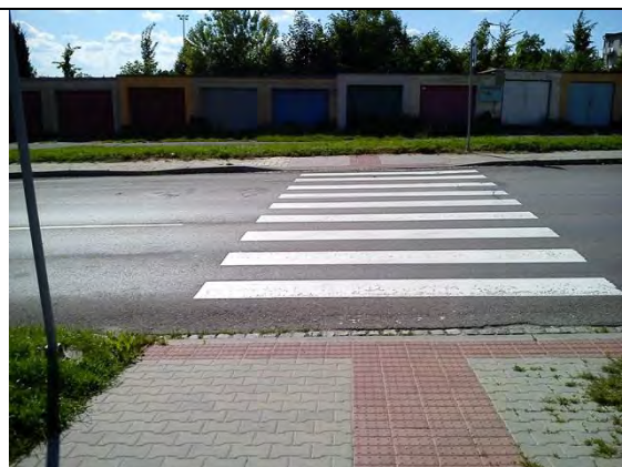
S4p Přechod přes Praktickou u zastávky Školní statek Bariérový Nenormová délka přechodu. Chybí vodící pás. Přechod je vyznačen přes plochu zastávky.
