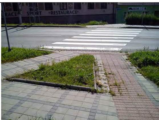
P5p Přechod přes Dolní Valy U Dvou oveček Bariérový Nenormová šíře chodníků. Navádění signálním pásem nesouhlasí s vyznačením přechodu. Krátké varovné pásy.
