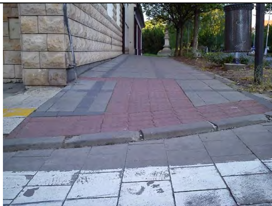
Z2p Přechod přes U Sboru směr U Žlebu Bariérový Nedostatečně snížená obruba.
