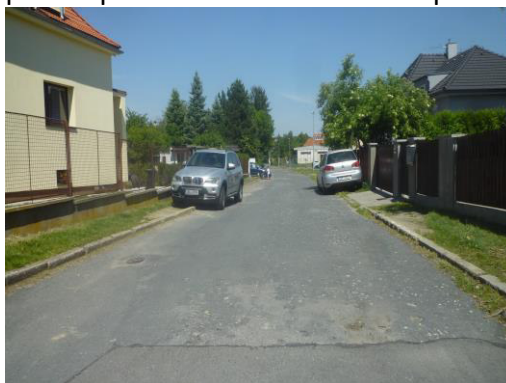
Asfaltový povrch se středními poruchami
