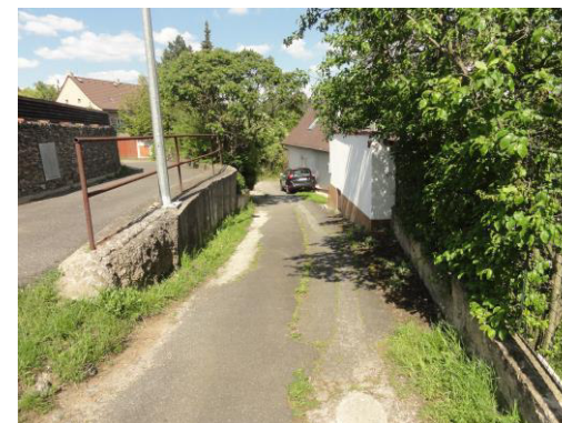
Asfaltový povrch v havarijním stavu
