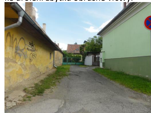
Asfaltový povrch v havarijním stavu
