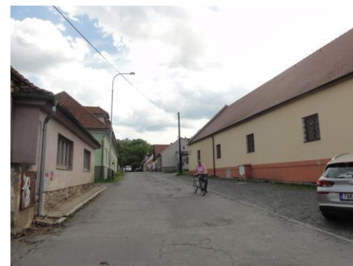
Asfaltový povrch s těžkými poruchami
