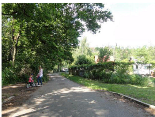
Asfaltový povrch s lehkými poruchami
