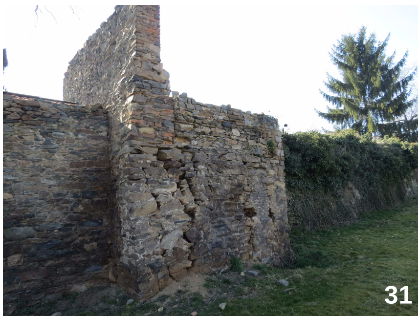
ROZPADAJÍCÍ SE ZDIVO HRADEB
