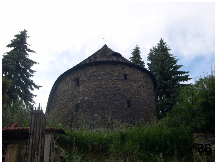
ROZPADAJÍCÍ SE ZDIVO HRADEB
