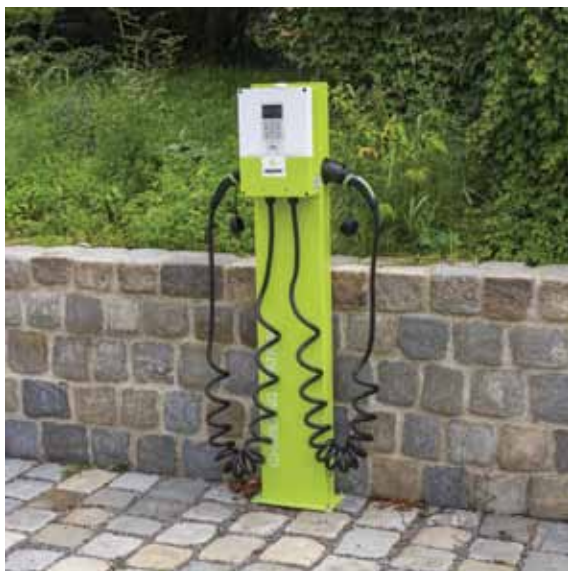
Dobíjecí stanice bez reklam, přimknutá k opěrné zdi, provedení bez nadbytečných reklam Obr. B180 | Telč
