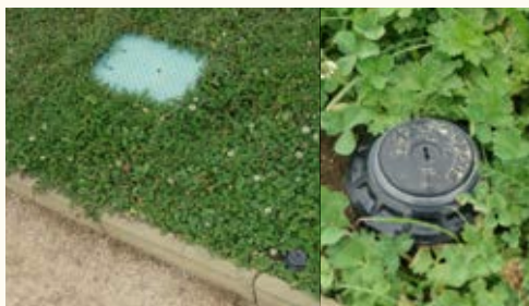
Typická šachtice a postřikovač Luhačovice – kolonáda
