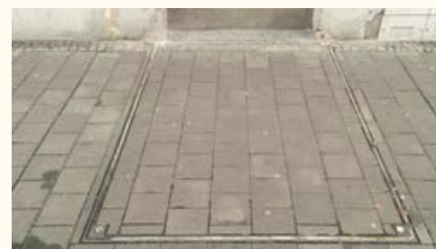
Poklop začleněný do betonové dlažby Brno - ulice Husova
