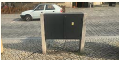
Rozvaděč pro dočasné akce je plnohodnotnou součástí městského mobiliáře Polička – Palackého náměstí
