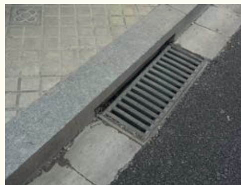
Litinová kanalizační vpust zarovnaná s krajníkem Barcelona – El Poblenou
