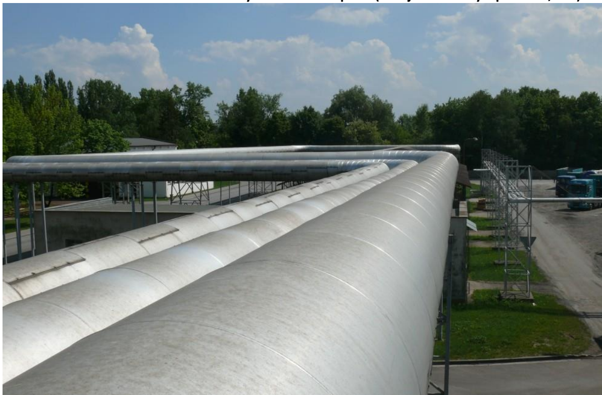
Obrázek 10 Foto distribuční soustavy zásobování teplem (Zdroj: Elektrárny Opatovice, a.s.)
