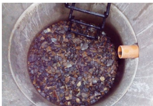
↑ Vsakovací šachta, Svatá Maří, zdroj: Zdeněk Nový
