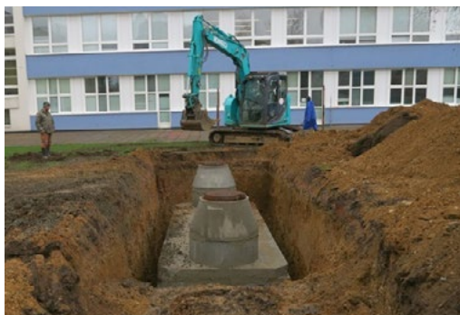
↑ Podzemní retenční dešťová nádrž – betonová nádrž, Praha 4, zdroj: Praha 4
