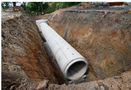
↑ Podzemní retenční dešťová nádrž – trubní retence, Kralovice, zdroj: www.babc.cz
