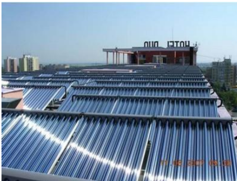
Obrázek 21 Vakuové termické kolektory mohou být využity po delší část roku než klasické ploché kolektory (zdroj: PORSENNA)
