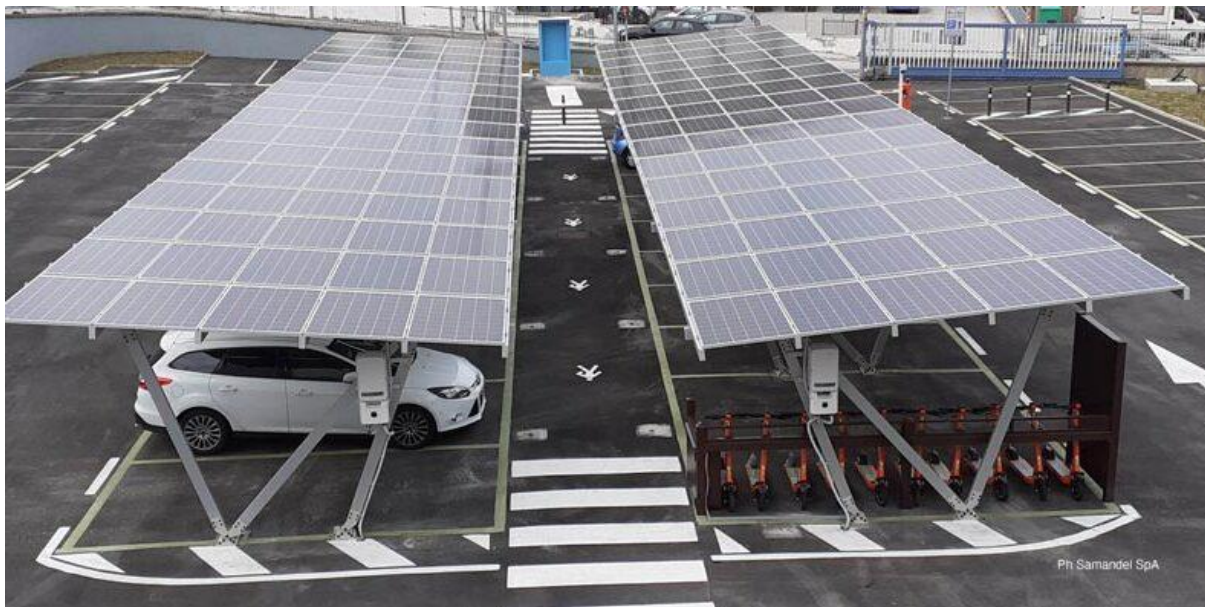
Obrázek 22 Ilustrační foto zastřešeného parkoviště - carportu (zdroj: www.futurasun.com )
