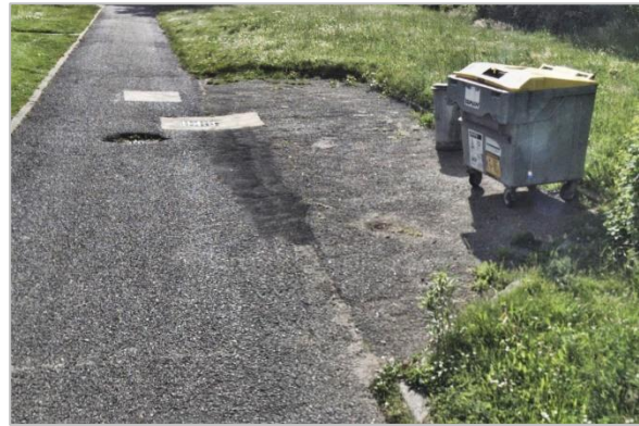
22/ Výhybna částečně zabraná nádobami na odpad (ulice Bezejmenná)
