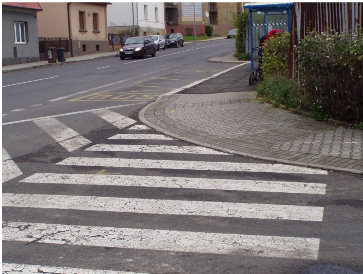
Obrázek 101: Nevyhovující řešení signálních pásů, zastávka MHD Chudeřín
