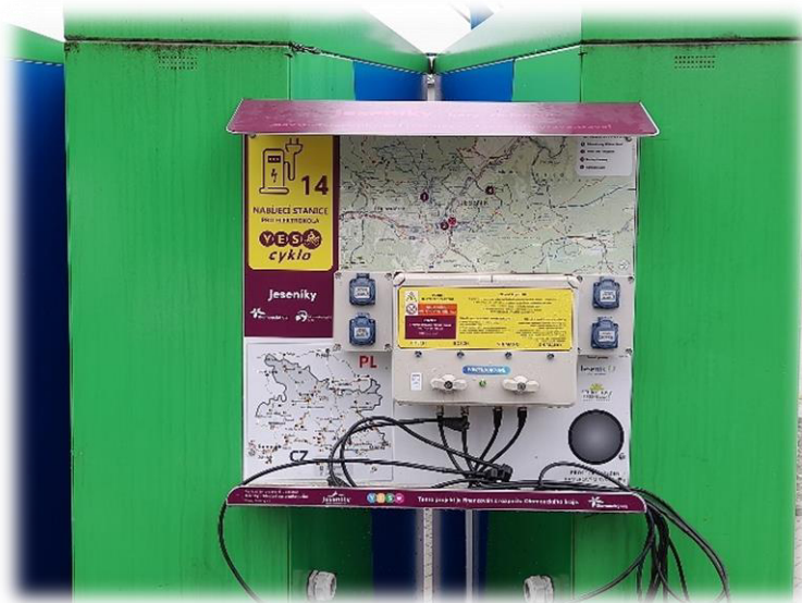
Obrázek 25 Stávající dobíjecí stanice na parkovišti Štefánikova
