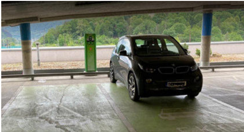
Obrázek 27 Dobíjecí stanice v ulici Bílinská (zdroj: maps.google.com)
