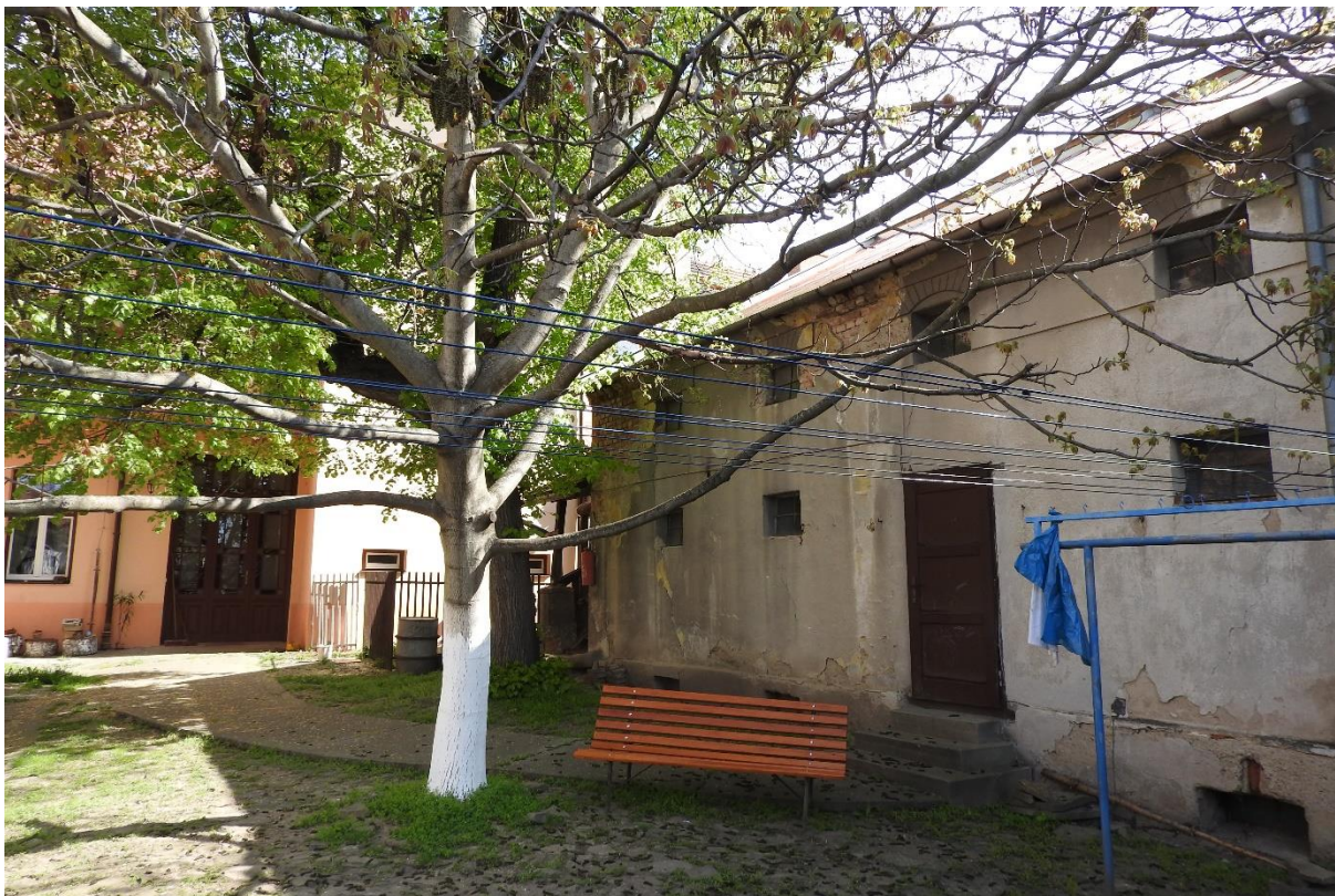
Obr. 23 / Sušárna bylin Měšťanského domu č. p. 164 – současný stav vyžadující obnovu
