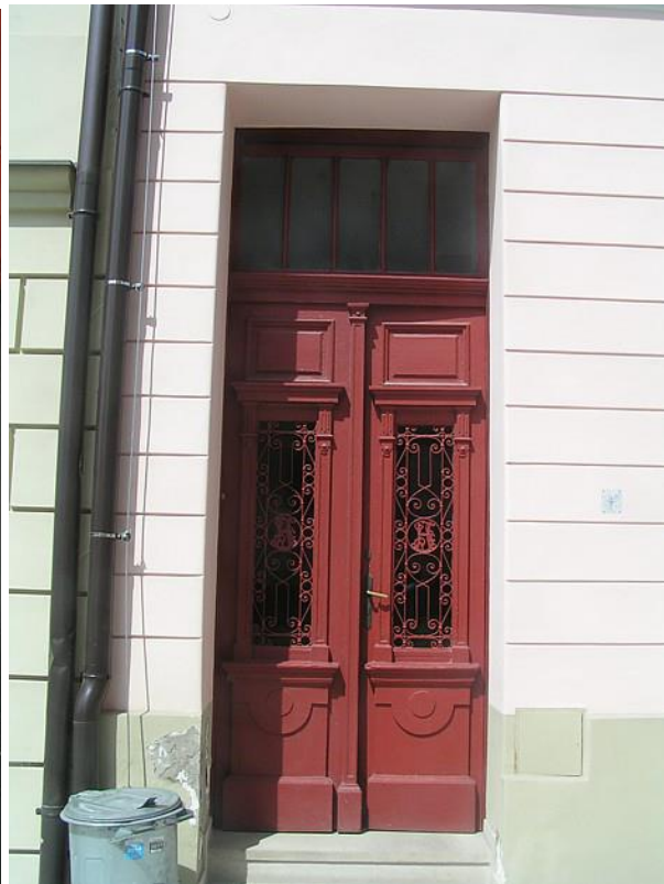
Obr. 22b / Vstupní dveře domu č .p. 202 (plánovaná repase)
