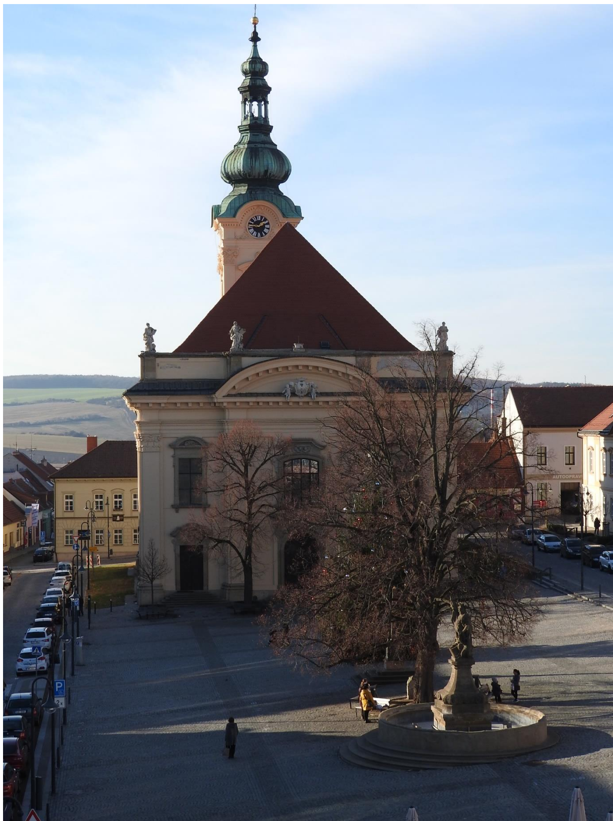
Obr. 20 / Kostel Neposkvrněného Početí Panny Marie – nutná obnova atiky (chybí 2 sochy)
