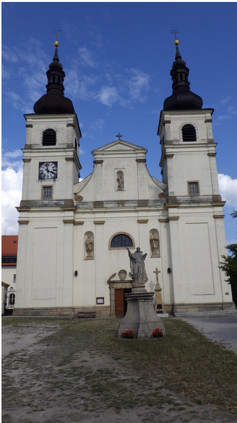
Obr. 21 / Kostel Nanebevzetí Panny Marie – nutná obnova fasády, pokračování restaurování kamenných prvků, úprava předprostoru
