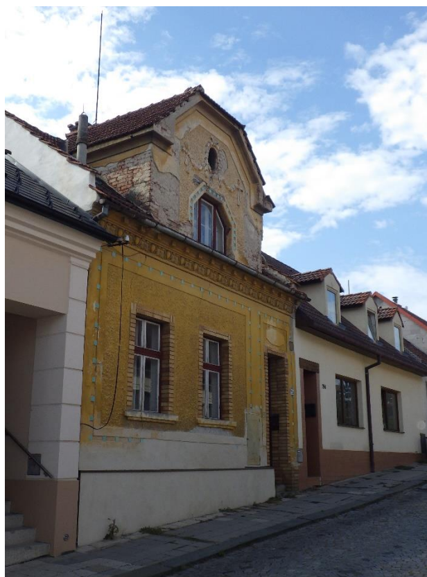
Obr. 18 / Dům čp. 53 v MPZ - současný stav vyžadující kompletní obnovu
