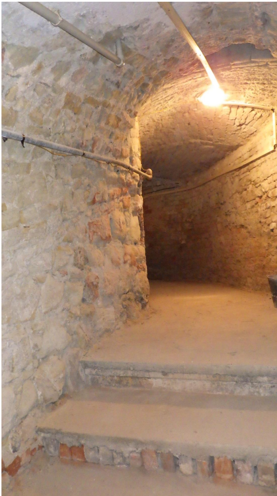
Obr. 24 / Měšťanský dům č. p. 201 – sklepy vyžadující obnovu
