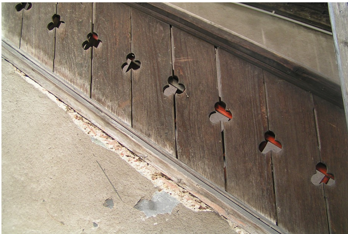
Obr. 8c / Měšťanský dům č.p 164 , detail dřevěné zábrany u schodiště (havarijní stav)
