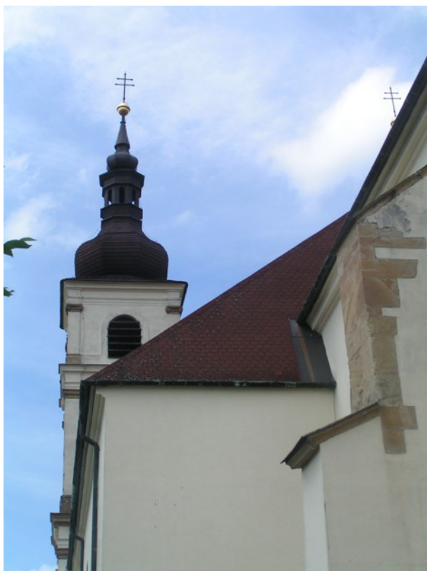
Obr. 17b / Kostel Nanebevzetí Panny Marie nevhodná krytina
