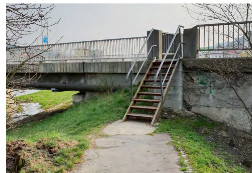
10 – středně závažný – okolní prostředí – úzký prostor pro chodce most (20,8 km)
