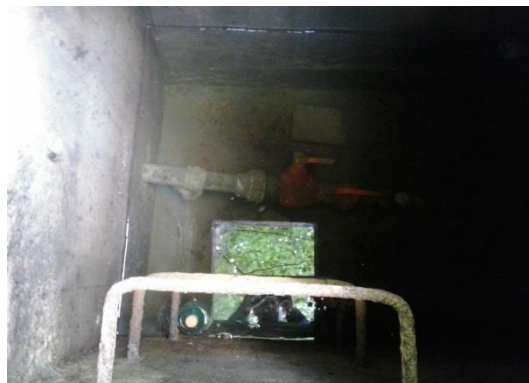
Vodoměr ve vodoměrné šachtě
