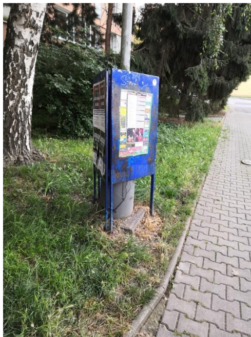
Obrázek 77 – Příklad špatně umístěné reklamy, bránící přístupu údržby
