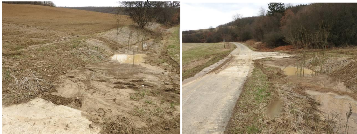
Obrázek 41 Vodní eroze na zemědělské půdě v lokalitě Zákřov
