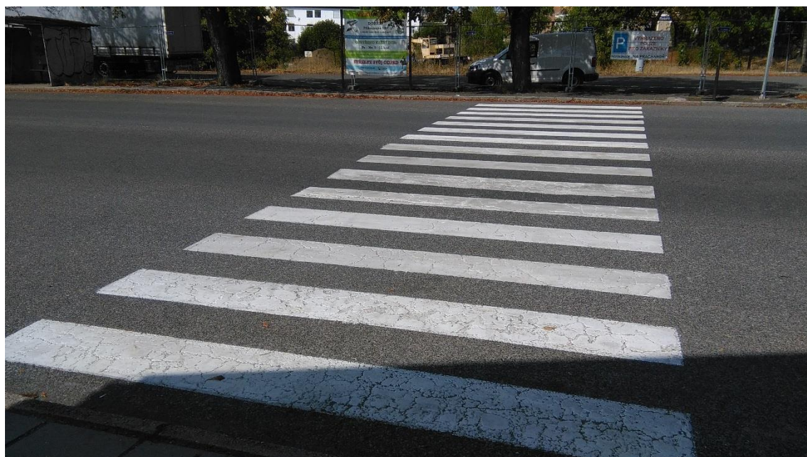
Obr. 17 Velmi dlouhý přechod přes ulici Pražská mezi autobusovými zastávkami (cca 16 m)
