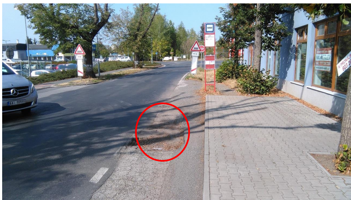
Obr. 12 Díry v komunikaci u autobusové zastávky Dobříš, železniční stanice (ulice Knínská)
