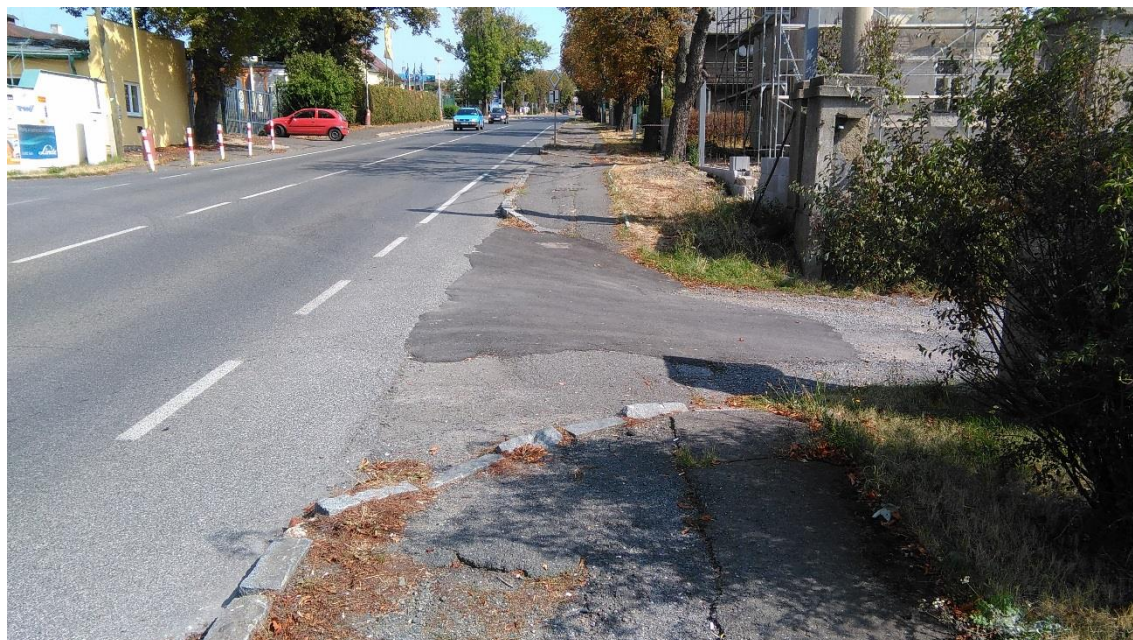
Obr. 19 Chodníky v ulici Pražská (severní části) ve velmi špatném technickém stavu
