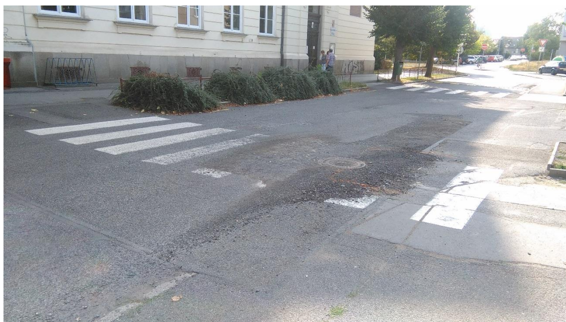
Obr. 8 Přechod pro chodce v ulici za Poštou – vhodné provést nové VDZ
