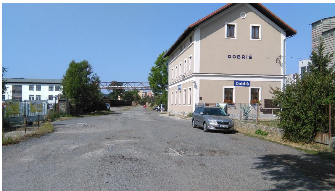
Obr. 10 Poničená vozovka na příjezdové cestě k železniční stanici Dobříš
