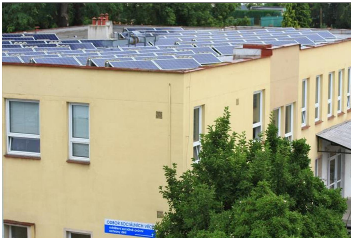
Obr. 13: Příklad dobré praxe: Fotovoltaika na MěÚ Chrudim
