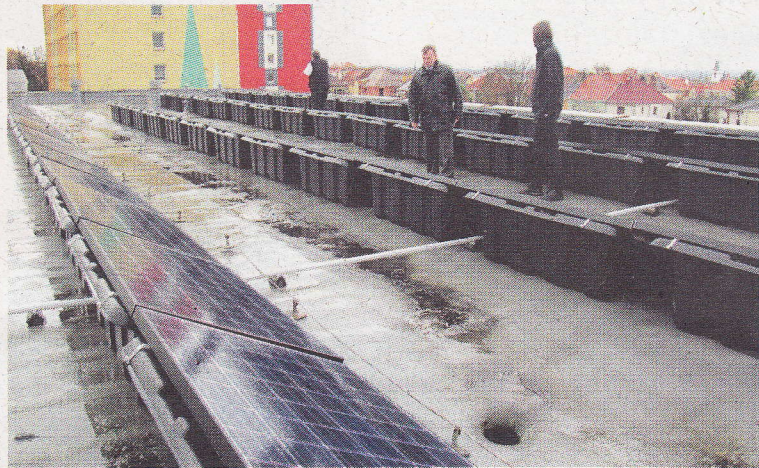
Také elektrárna na střeše ZŠ Havlíčkova je už v provozu. FOTO | VÁCLAV SEDLÁK
