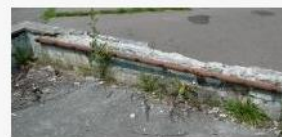
poškozený bazén, 7/2016 ZK
